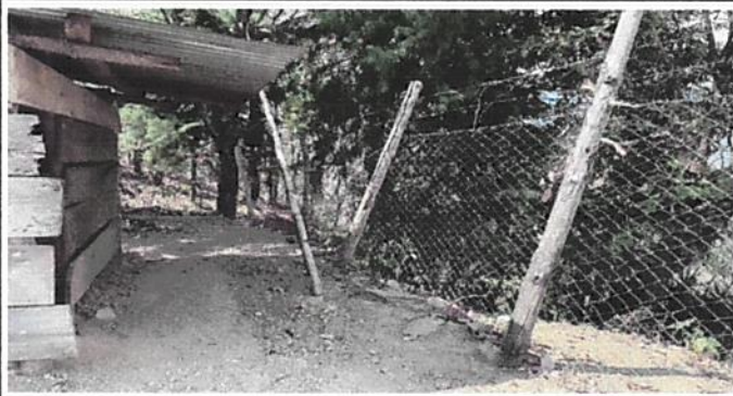
Foto 3. serco de maya galvanizado en mal estado
