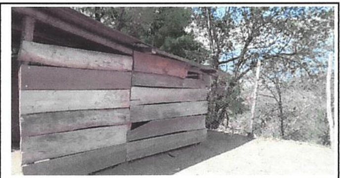
Foto lamina con fuga por deterioro
