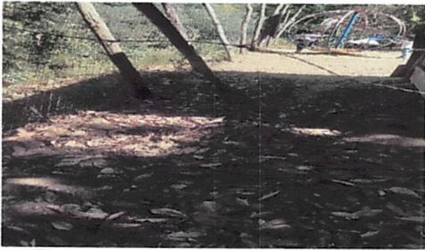
Foto 3. serco de maya galvanizado en mal estado
