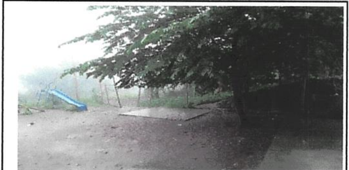
Foto lamina con fuga por deterioro
